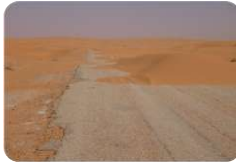
(a) Risque d'ensablement sur la route Hassi Messaoud vers El-Borma. RN53A
