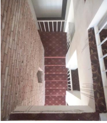
الصورة 56: صورة لسلم الطوارئ 2
