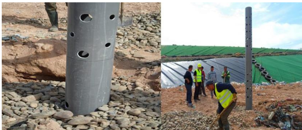
Figure 17 : Système récupération de biogaz
