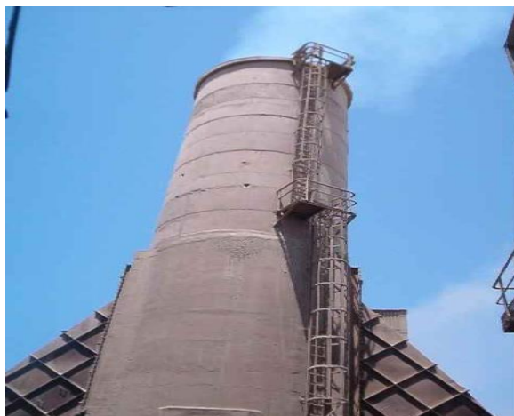
Figure 25 : Tour de conditionnement d'épuration de gaz
