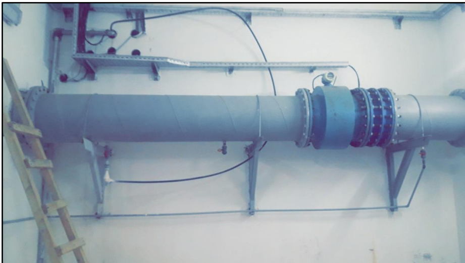
Fig.36 : La chloration (Photo prise par M lle . F. BOUALI & M lle . A. BRAHIM au niveau de la station de traitement Sekkak, Tlemcen, le : 27/05/2021).
