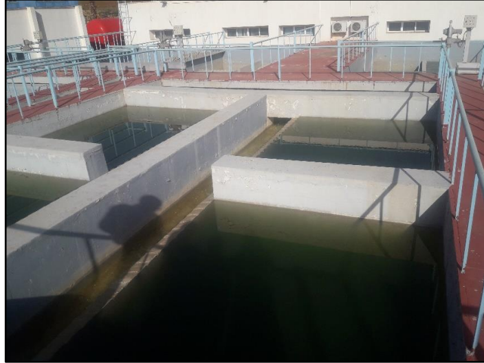
Fig.30 : Bassin de décantation (Photo prise par M lle . F. BOUALI & M lle . A. BRAHIM au niveau de la station de traitement Sekkak, Tlemcen, le : 04/04/2021).
