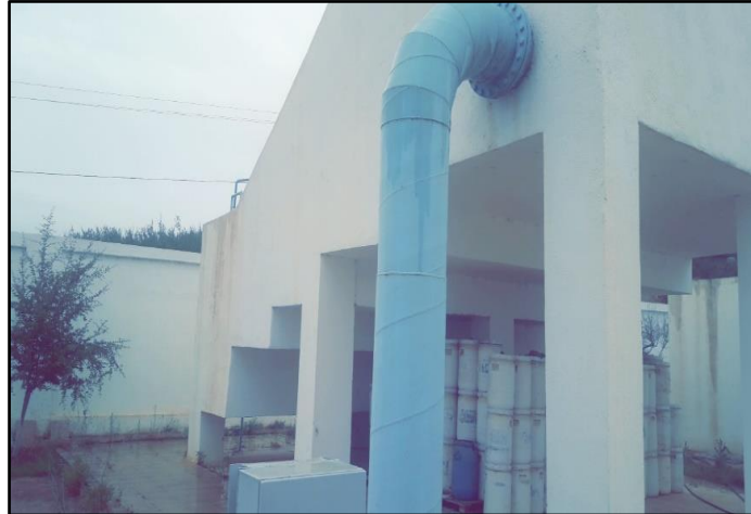
Fig.25 : La conduite qui délivre l'eau de pré-chloration à la cascade d'aération (Photo prise par M lle . F. BOUALI & M lle . A. BRAHIM au niveau de la station de traitement Sekkak, Tlemcen, le : 27/05/2021).
