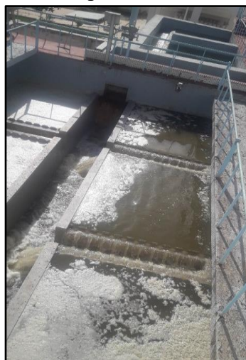
Fig.34 : Lavage des filtres à sable (Photo prise par M lle . F. BOUALI & M lle . A. BRAHIM au niveau de la station de traitement Sekkak, Tlemcen, le : 04/04/2021).
