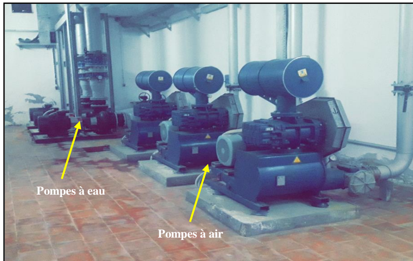
Fig.35 : Les pompes à air et à eau qui rentre dans le lavage des filtres (Photo prise par M lle . F. BOUALI & M lle . A. BRAHIM au niveau de la station de traitement Sekkak, Tlemcen, le : 27/05/2021).
