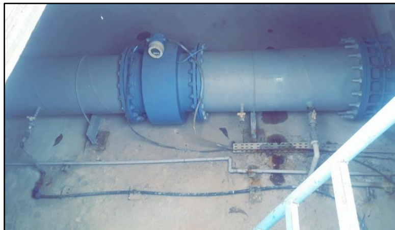
Fig.24 : Chambre des vannes (Photo prise par M lle . F. BOUALI & M lle . A. BRAHIM au niveau de la station de traitement Sekkak, Tlemcen, le : 27/05/2021).
