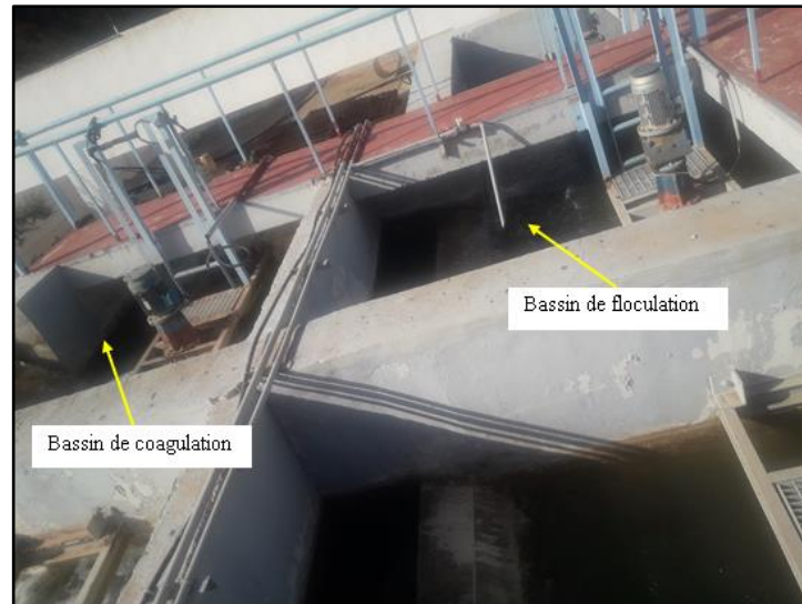
Fig.27 : Sous bassins de Coagulation – Floculation (Photo prise par M lle . F. BOUALI & M lle . A. BRAHIM au niveau de la station de traitement Sekkak, Tlemcen, le : 04/04/2021).
