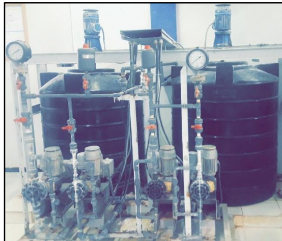
Fig.23: Bac de Polymère (Photo prise par M lle . F. BOUALI & M lle . A. BRAHIM au niveau de la station de traitement Sekkak, Tlemcen, le : 27/05/2021)
