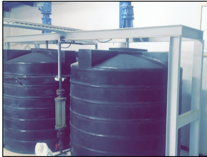
Fig.22: Bac d'Hypochlorite de Calcium (Photo prise par M lle . F. BOUALI & M lle . A. BRAHIM au niveau de la station de traitement Sekkak, Tlemcen, le : 27/05/2021)
