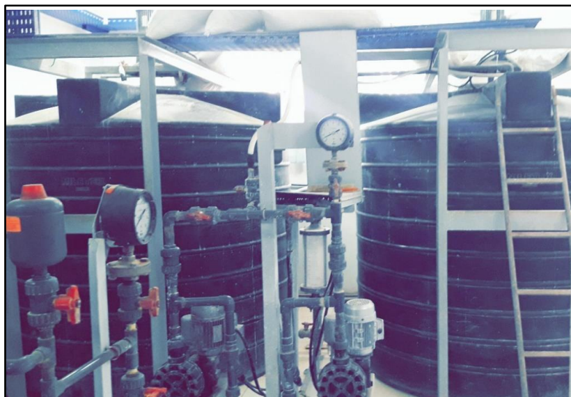
Fig.21: Bac de Sulfate d'Alumine (Photo prise par M lle . F. BOUALI & M lle . A. BRAHIM au niveau de la station de traitement Sekkak, Tlemcen, le : 27/05/2021)
