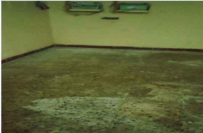
Figure N° 14: Photo montrant la persistance de la crasse sur le sol au niveau de l'entreprise.
