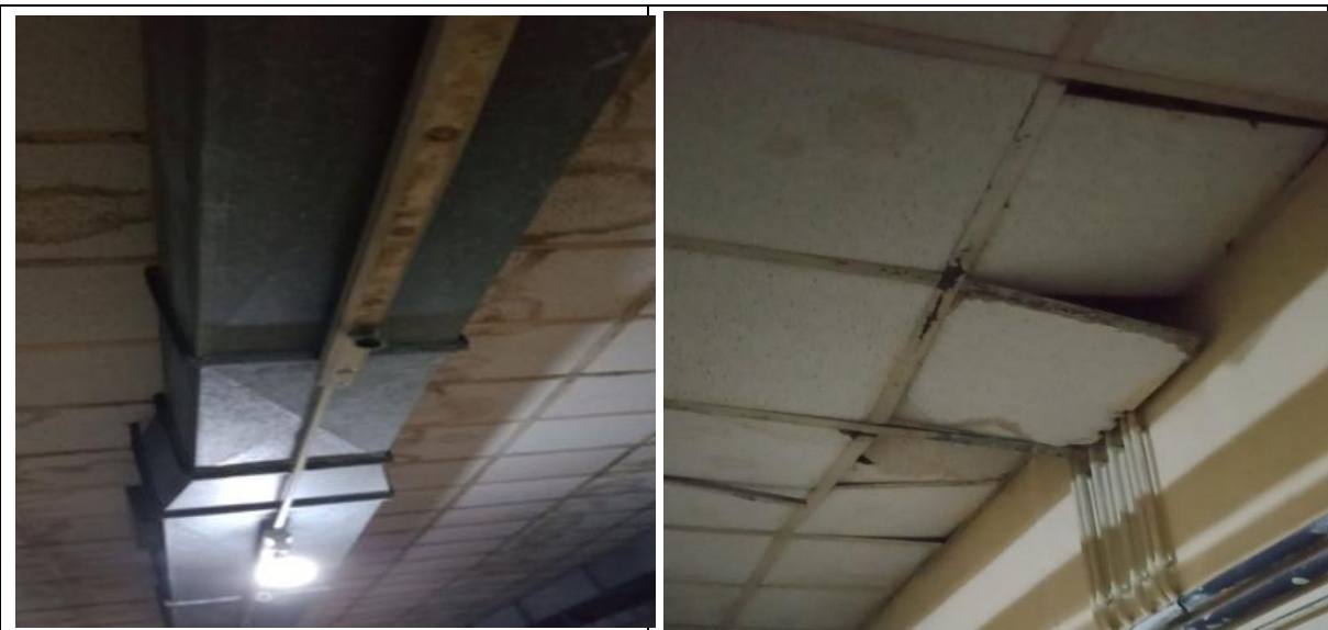
Figure 12 : Deux photos montrant l'état de dégradation du plafond
