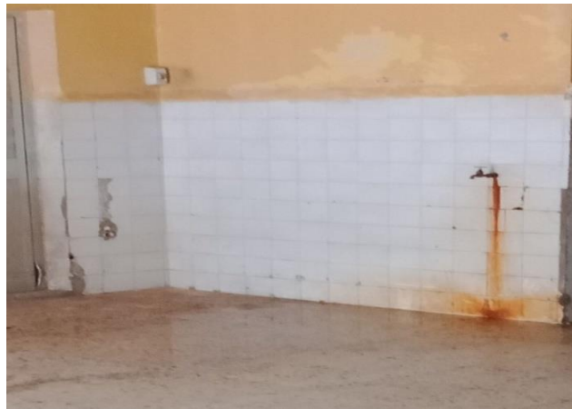
Figure 16 : Photo illustrant l'état de la fiance et de la plomberie.
