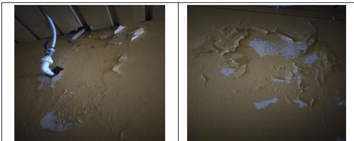
Figure 13 : Deux photos montrant l'état de dégradation de la peinture des murs
