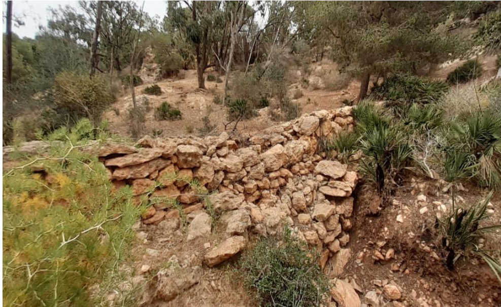
Photo 5 : seuil en gabion stable avec grillage coupé et volé, bonne fondation et bon ancrage (Cliché Zékri et El-Bordji, 19 juin 2021)
