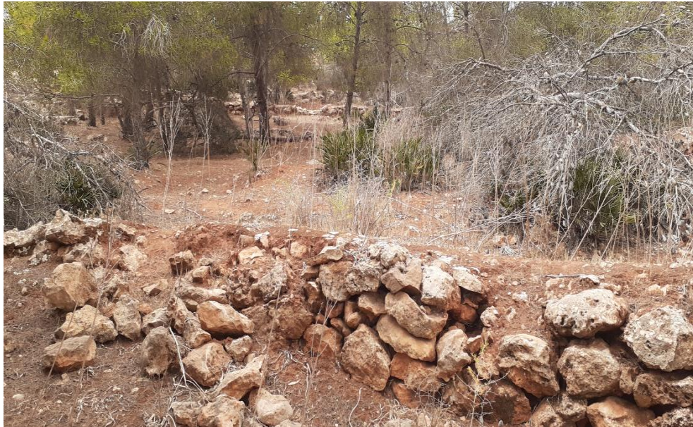
Photo 8 et 9 : terrasses avec murettes en gradins (Certaines pierres de murettes ont été emportées par la force du courant d'eau) (Cliché Zékri et El-Bordji, 19 juin 2021)
