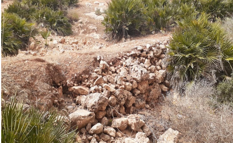
Photo 7 : seuil en pierres sèches instable dans son coté gauche à cause d'un mauvais ancrage (Cliché Zékri et El-Bordji, 19 juin 2021)
