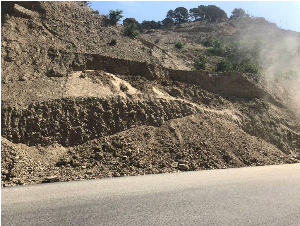
Figure 3 glissements talus après terrassement
