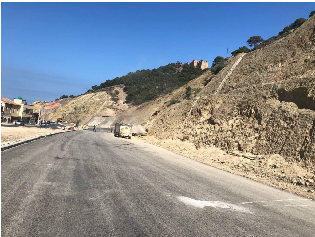
Figure 4 des détachements de sol sur les talus
