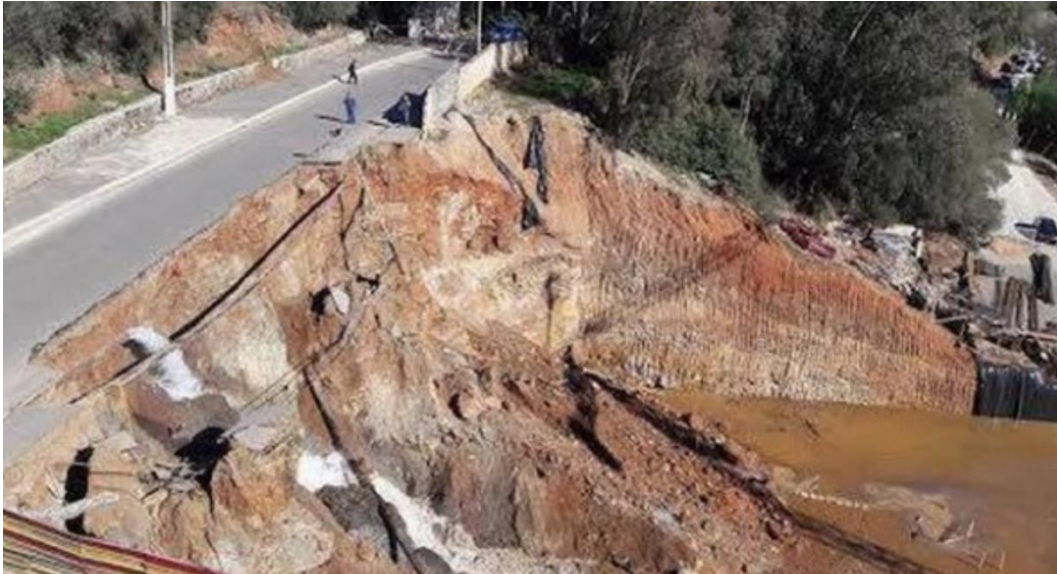
Figure 1.20. Glissement de terrain au niveau de la cité Céleste
