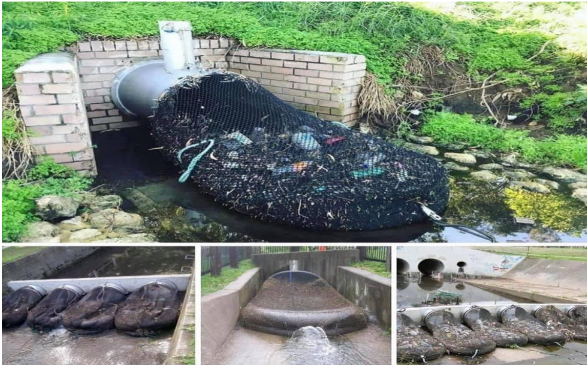
Figure n°16: les filets captant des rejets solides.
