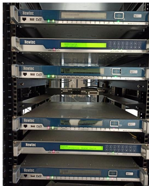
Figure III.8 Sous système modulateurs Newtec Satcom M6100.
