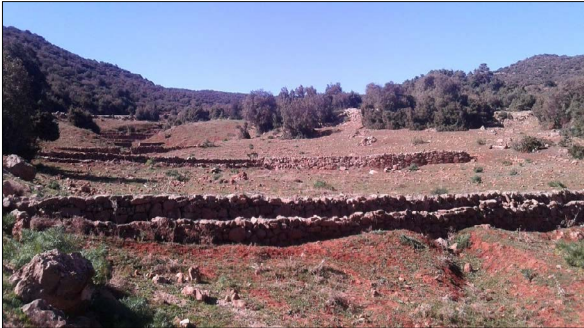
Fig. 26 : Photo montrant les travaux de corrections torrentielles dans la région de Ain Ghoraba, (ZAOUI M., 2018).
