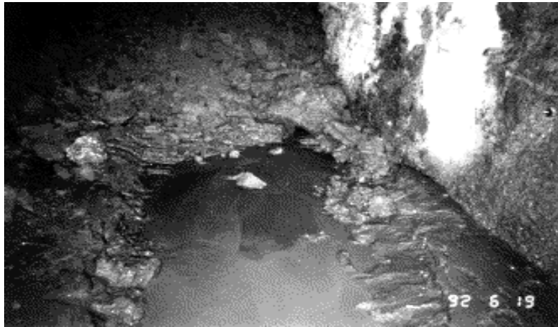
Figure 1.3 Inondation du tunnel de Wushantou, Japon 1992, Wang et al (2012) cité par Idris (2007).
