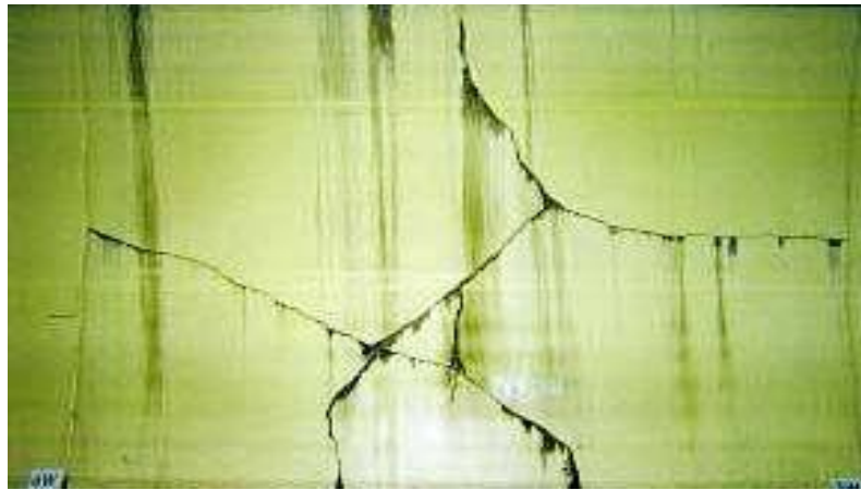
Figure 01.2 Tunnel de A38 saltash (Royaume-Uni, 1997) fissuration sur les parois Sauer (2004) Cité par Idris (2007).
