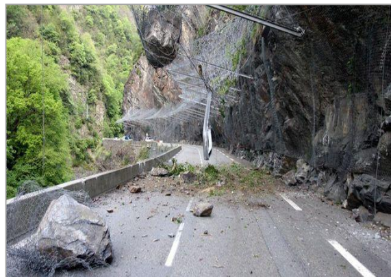
Figure 2.3 Éboulement sur la route dans les hautes Pyrénées, photo Laurent Dard Julien (2017)
