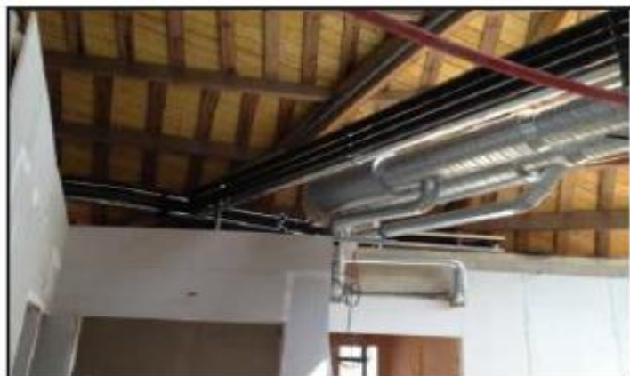
Figure 18 : système de ventilation
