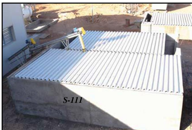
Fig.18 : Cuve à boues 'S-111'.
