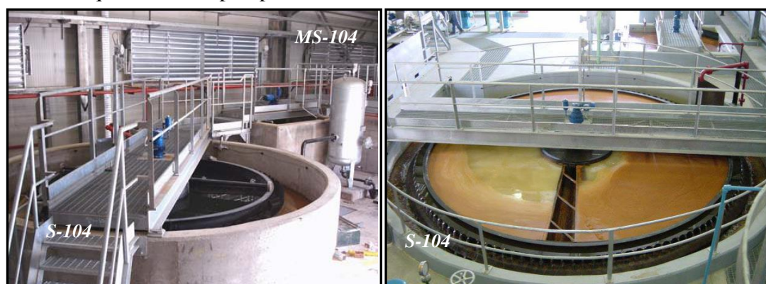
Fig.23 : Cuve de flottation 'S-104'.
