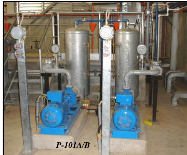
Fig.15 : Pompes de refoulement ' P-101A et B ' d'eau traitée vers l'unité de filtration.
