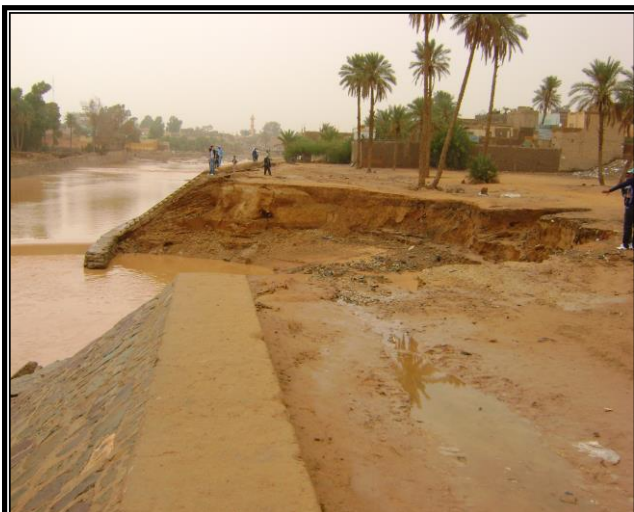
Le dégât causé par la crue d'Oct 2008 au niveau de Béchar centre (En face jardin publique)
