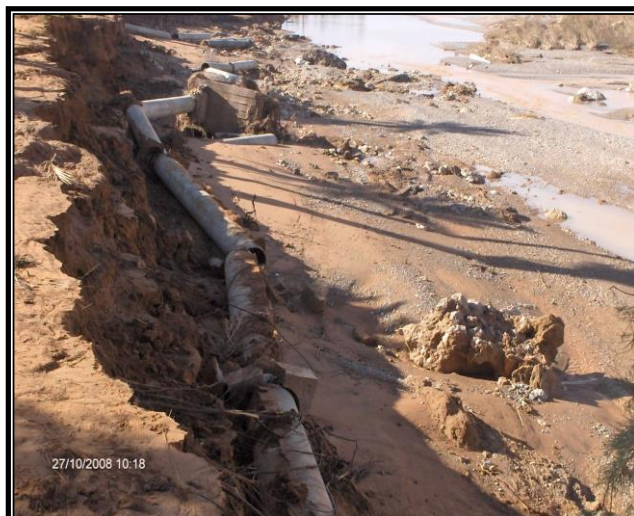
Le dégât causé par la crue d'Oct 2008 au niveau de Béchar centre (En amant du pont BAZAID)
