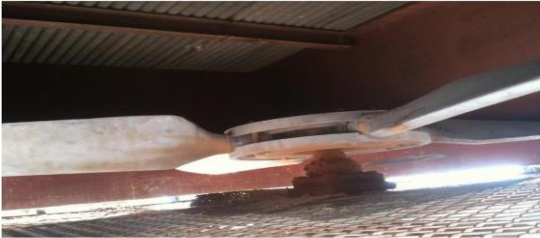
Figure III-16 : Ventilateur à tirage forcé
