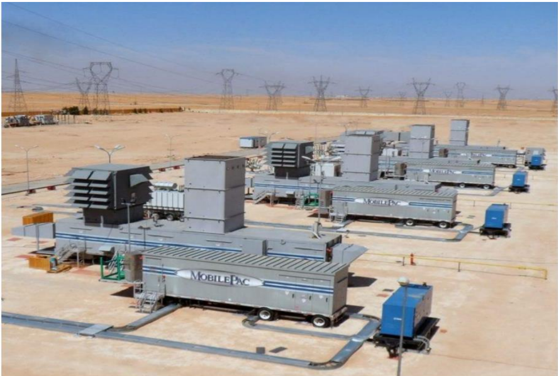
Figure I-7 : centrale TG mobile, Hassi-Messaoud, HMO
