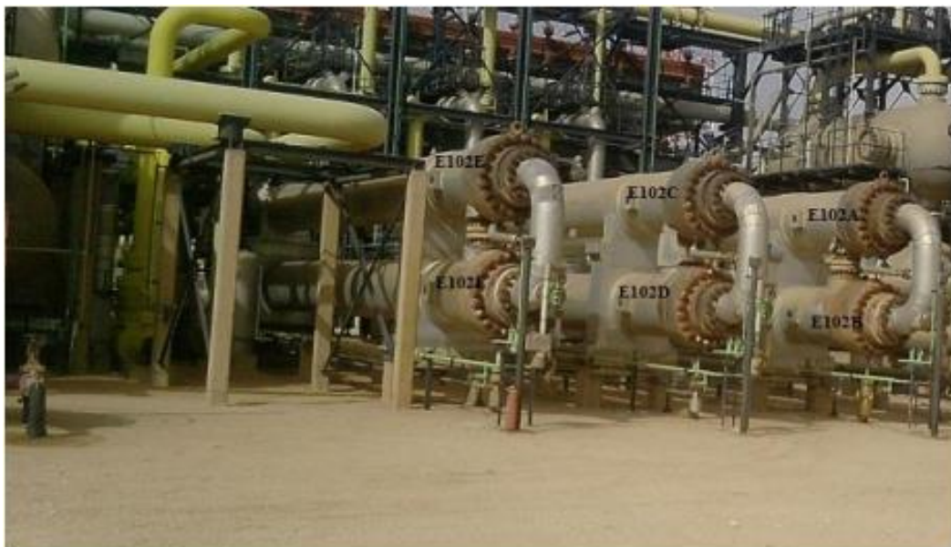
Figure III-19 : échangeur de chaleur eau/huile (E102)
