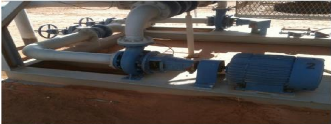
Figure III-18 : Pompe eau de refroidissement 88WC.
