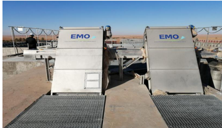
Figure I.3 : Dégrilleurs droites de la nouvelle station d'épuration de la ville de Timimoune. Photo prise par moi-même.
