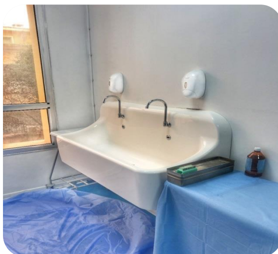
Figure 3 : Salle de lavage chirurgical des mains du service de chirurgie B.
