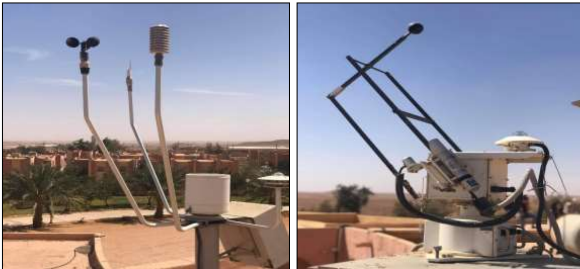
FigIII.9 Photographie des Appareillages de mesures de rayonnement, température et d'humidité relative de l'air ambiant
