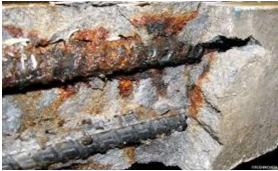
Corrosions des aciers
