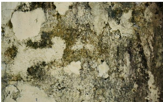
Apparition de moisissures
