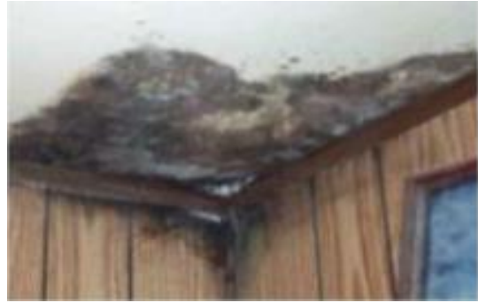
Détérioration du plafond
