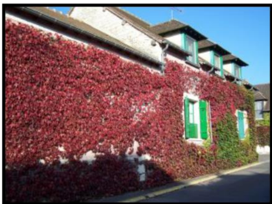
Figure 89: Mur couvert par de la vigne vierge fixé par leurs crampons Source : www.givernews.com
