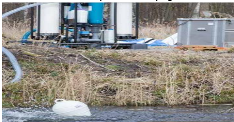
Figure N°3.6 : Captage d'eau pour le traitement mobile [36]
