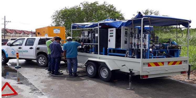
Figure N°3.7 : L'installation d'unité mobile de traitement de l'eau [42]
