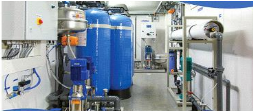
Figure N°3.1 : Intérieur du container d'un système mobile de traitement de l'eau [37]
