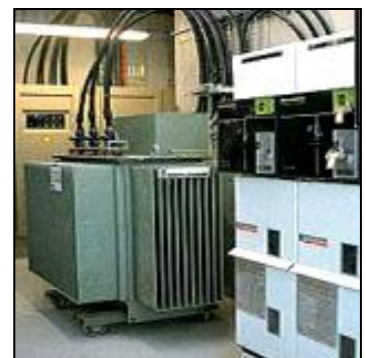
Figure110 : poste de transformation
