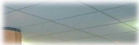
Figure 39: Les faux-plafonds absorbants en laine minérale revêtue
