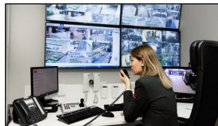
Figure 115: Poste de télésurveillance Source : http://www.agence-pacheco.com/video-surveillance-ip.php
