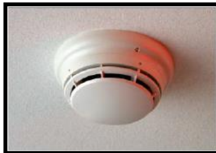
Figure 232 : détecteur du fumé
