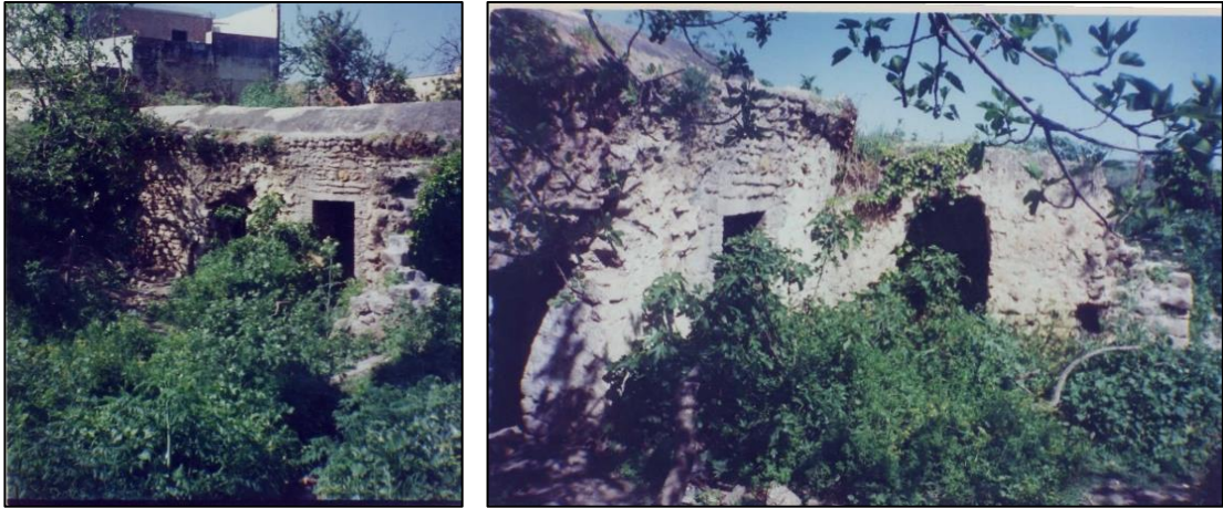
Photo 37: Etat du bain d'Agadir avant travaux de restauration en 2003. Source BET ACAT 369
