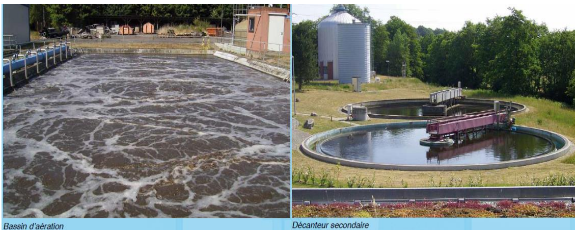
Figure I.6 : Bassin d'aération - Décanteur secondaire (Clarificateur) [13].
