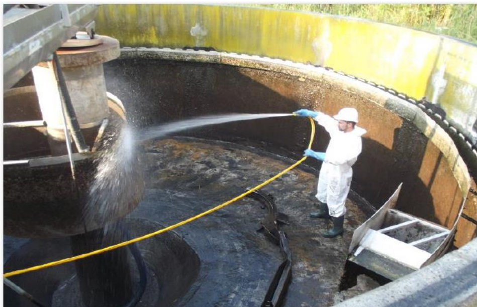
Figure I.11 : L'entretien d'un bassin d'une station d'épuration [22].
