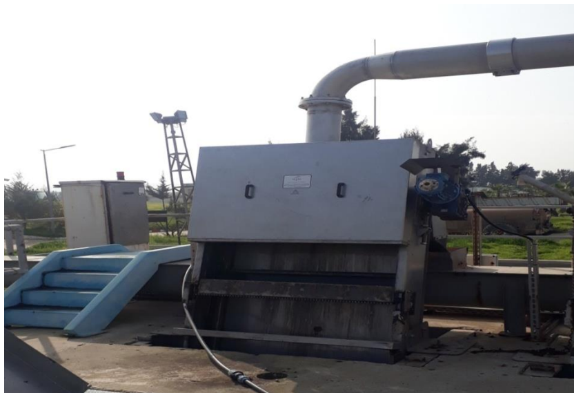
Figure III.3 : Dégrilleur fin mécanique.
