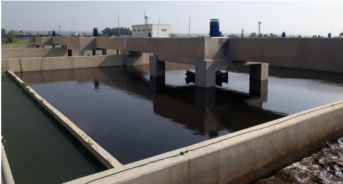
Figure III.6 : Bassin d'aération de la station d'épuration.
