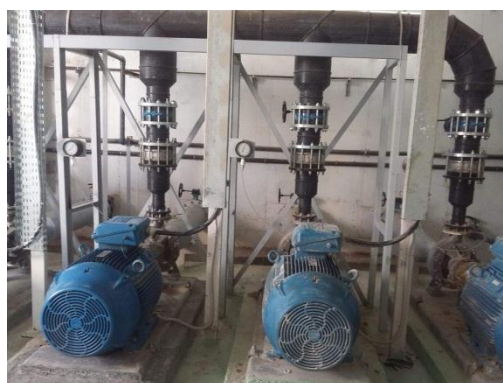
Fig. 46 Photo de pompe haute pression
