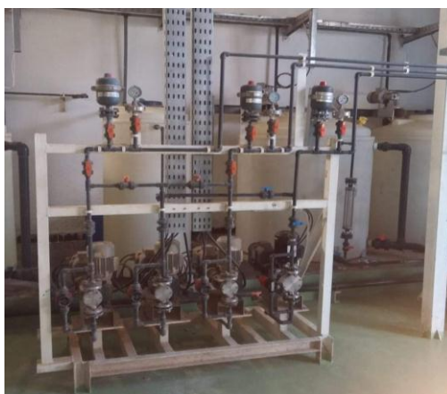
Fig. 44 Photo de la pompe injection d'antitartre (anti scalant)
