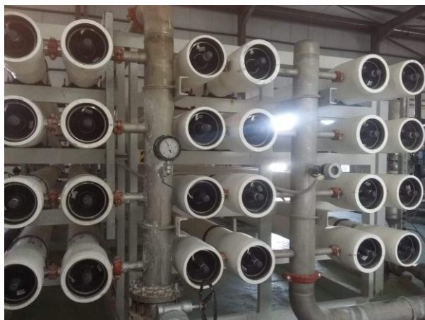
Fig. 48 Photo d'un étage d'osmose inverse
