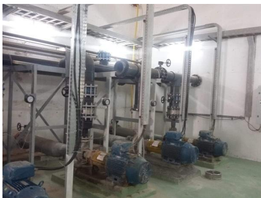
Fig. 42 Photo de la pompe de gavage
