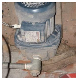
Figure I-7: Affichage pompe électrique
