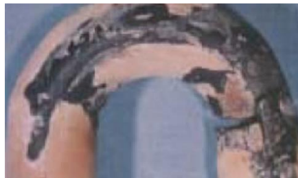
Figure A.17 : corrosion dans un tube en U [92]
