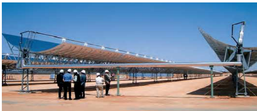
Fig.17. Les premières centrales électriques paraboliques en Europe. Les plus grandes centrales solaires au monde - Andasol 1 à 3
