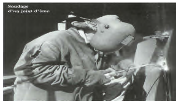
Figure 2.2 : Soudage à l'arc avec fil fourré
