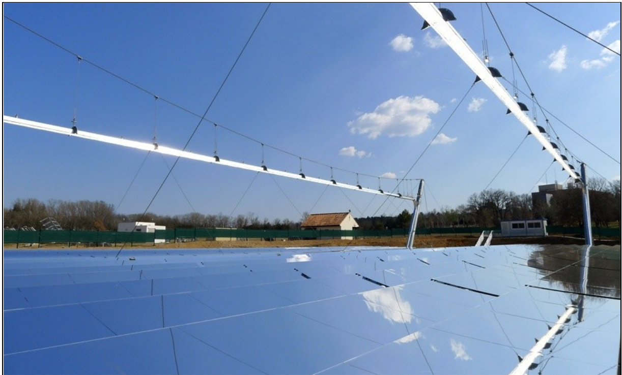
Figure (II.5) : Centrale solaires à miroirs de Fresnel, Fresdemo, Espagne [24]
