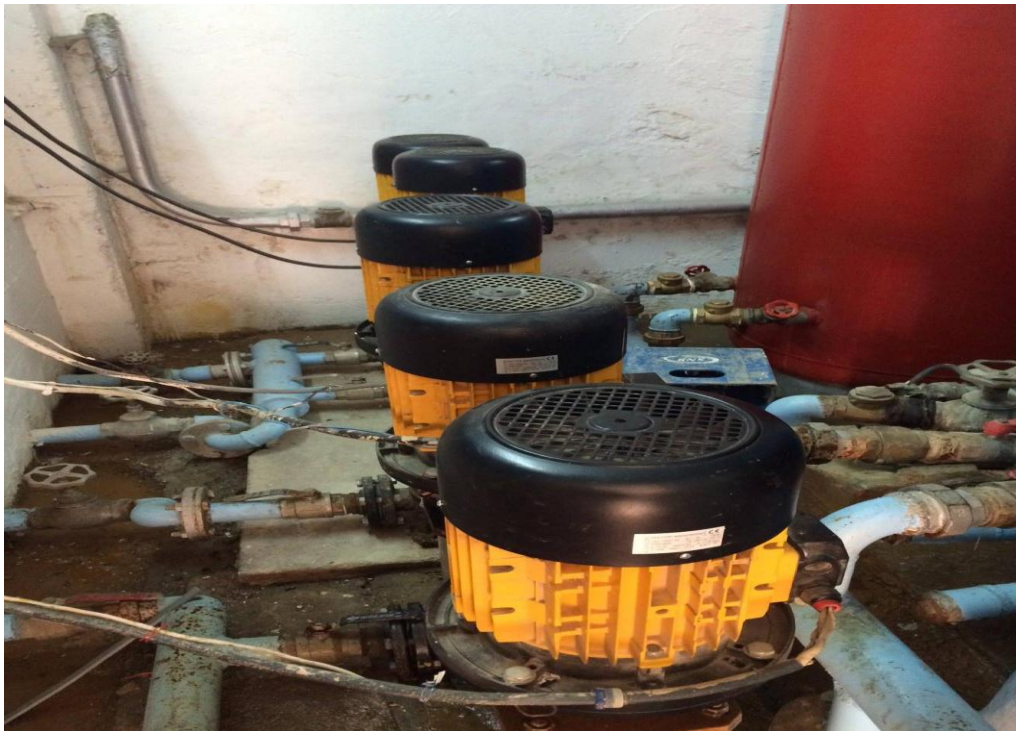
Figure1-4 : Les pompes de refoulement
