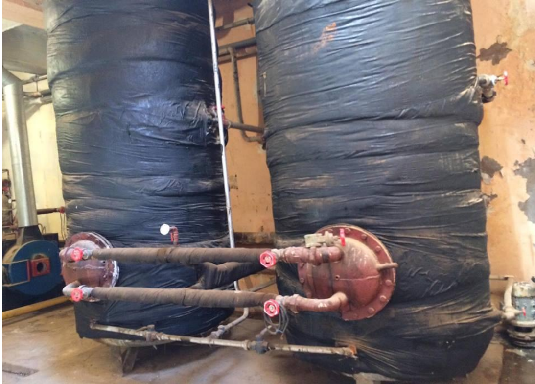
Figure1-6 : Ballons d'eau chaude
