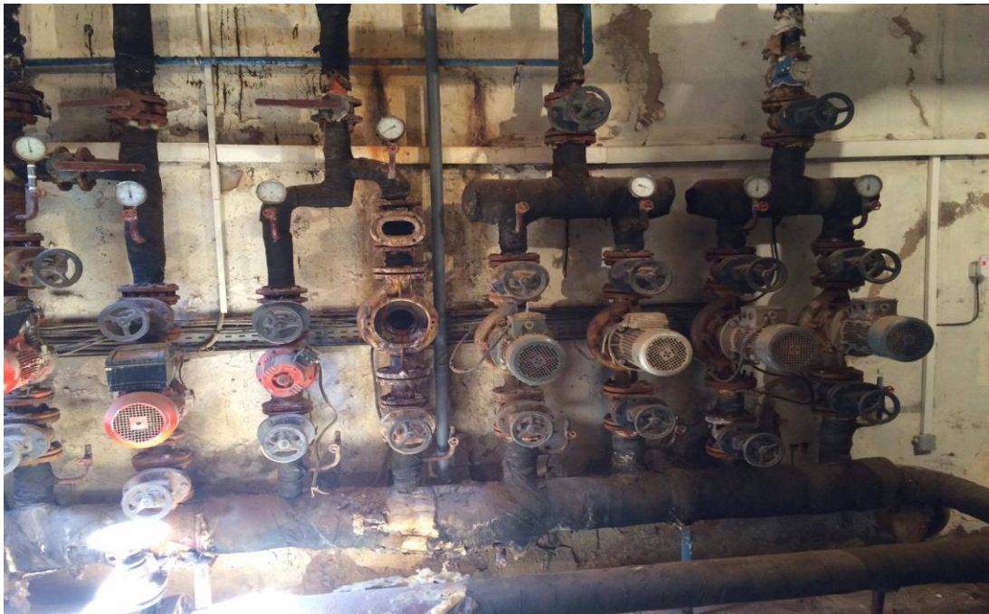
Figure1-7 : Pompes de recyclage
