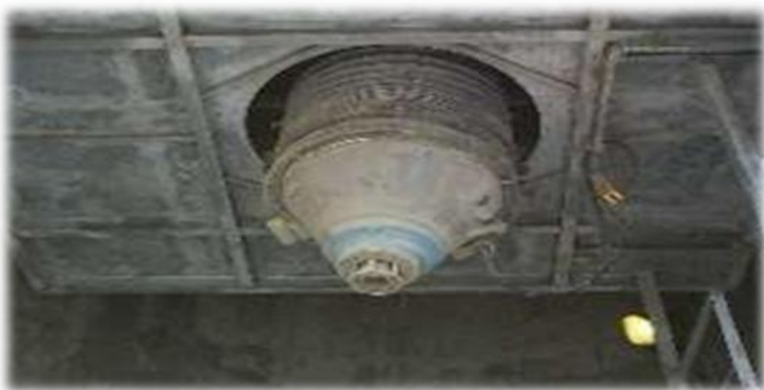
Figure 1.16. Station de remplissage [3].
