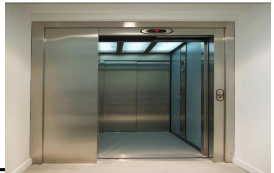
Figure 284 : Ascenseur de grande capacité
