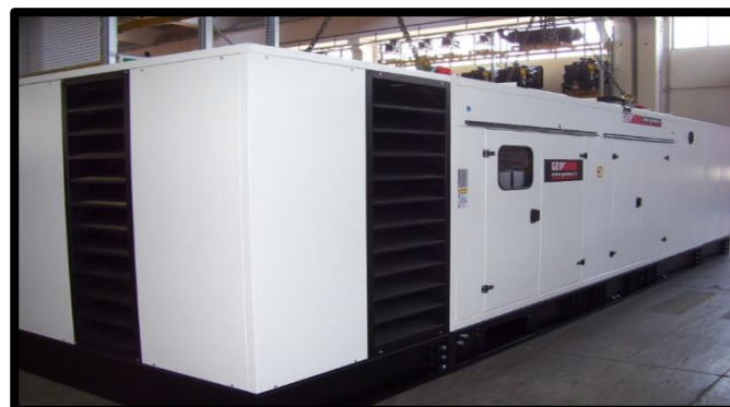
Figure 328 : Groupe électrogène 1000 KVA
