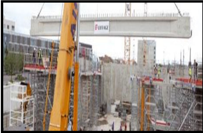
Figure 9 Poutre de 25m utilisé dans la structure du palais des congrès de METZ
