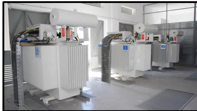
Figure 327 : poste de transformation électrique
