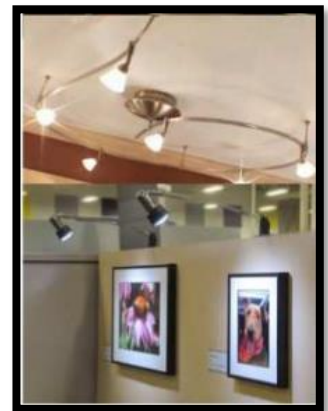
Figure 108 : Éclairage sur rail
