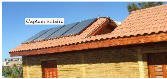
Figure 64. Les capteurs solaires dans le prototype (source : https://www.google.com , consulté le 12/11/2018 à 23h40)
