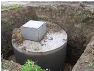
Figure 97. Cuve de stockage des eaux pluviales (source : Guide d'aménagement et de développement durable, pp 54).
