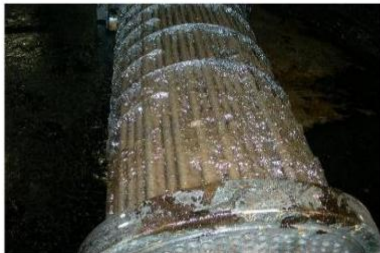
Figure I.25. Encrassement de l'échangeur de chaleur
