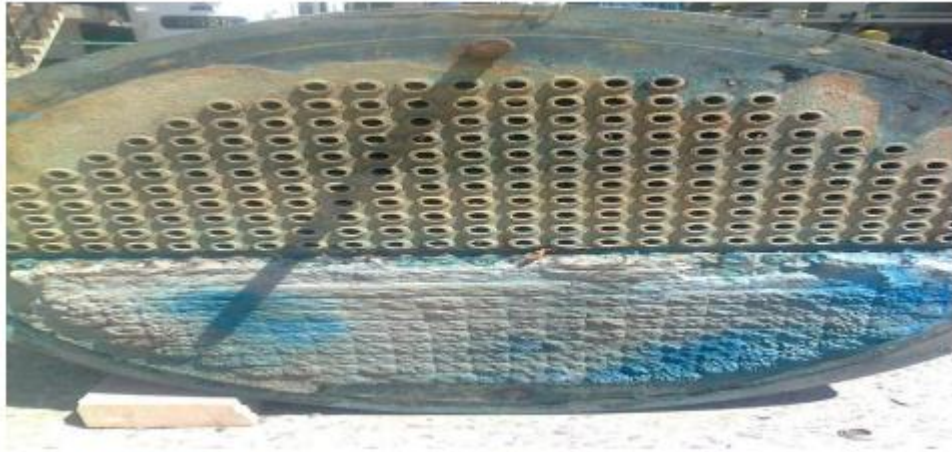
Figure I.26. Dépôt la tartre formée sur les faisceaux tubulaires de l'échangeur
