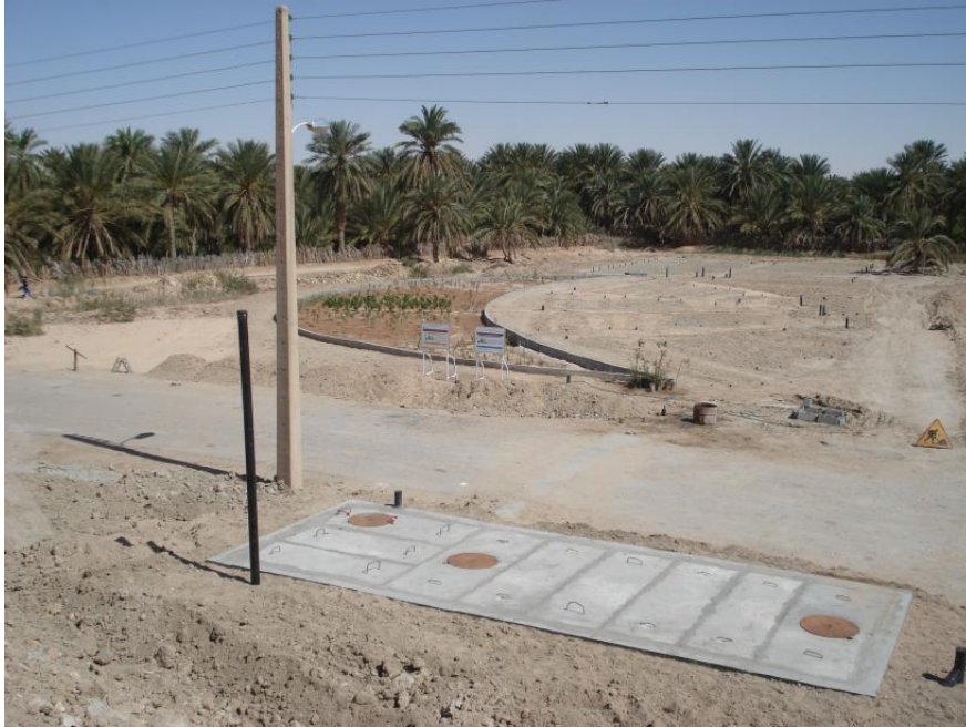
Figure A. 3: Vue générale de la station de Touggourt à filtre planté de macrophytes.
