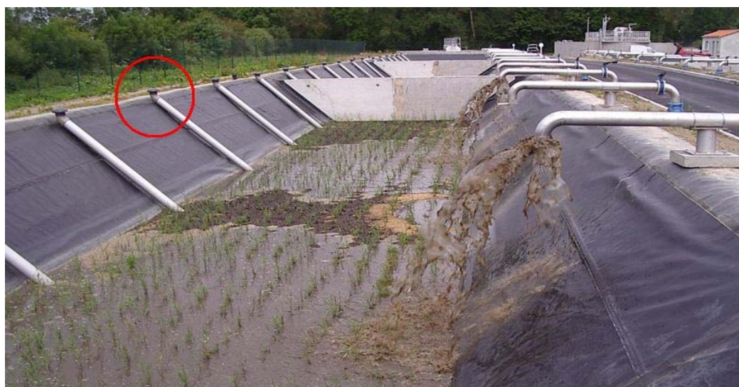
Figure 0.15: Bornes d'aérations de la station d'épuration à filtres plantés de roseaux de Treize Septiers
