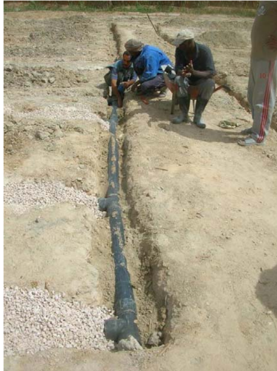
Figure A. 5: Photo prise lors de la réalisation de la conduite principale du réseau de drainage des eaux pour l'irrigation des arbustes.
