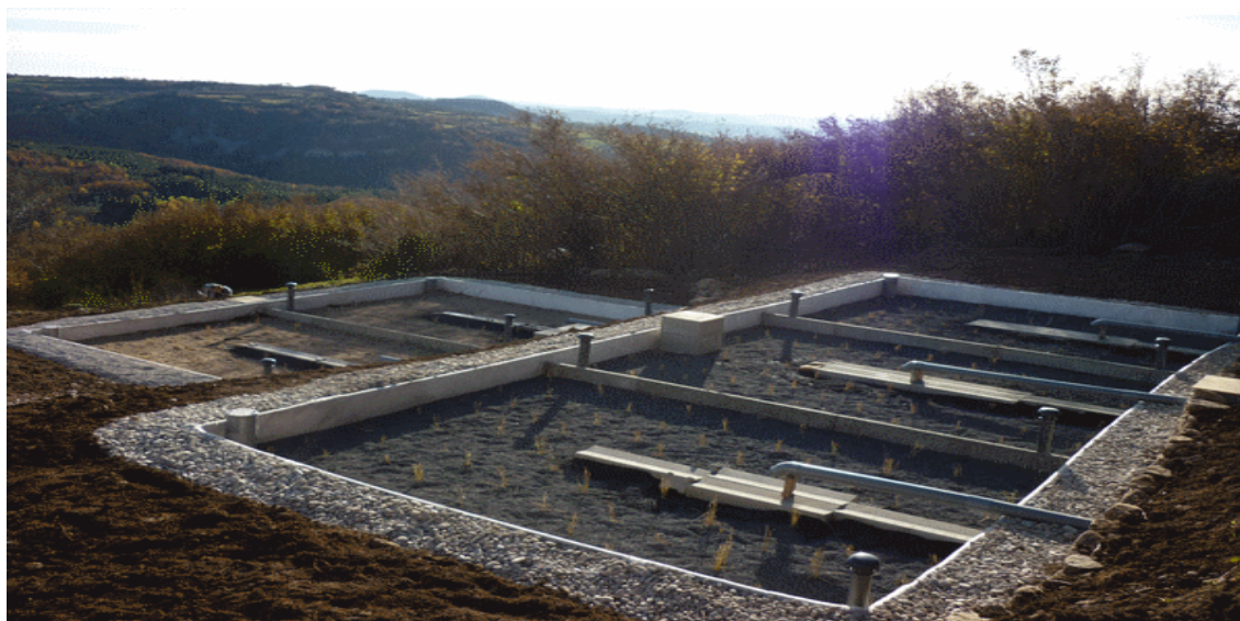
Figure 0.4: Système d'épuration mixte avec trois bassins à écoulement vertical en 1 er étage et deux bassins à écoulement horizontal en 2 ème étage.
