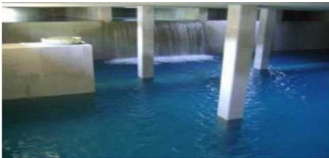
Figure IV.11: Réservoir de stockage de l'eau dessalée.
