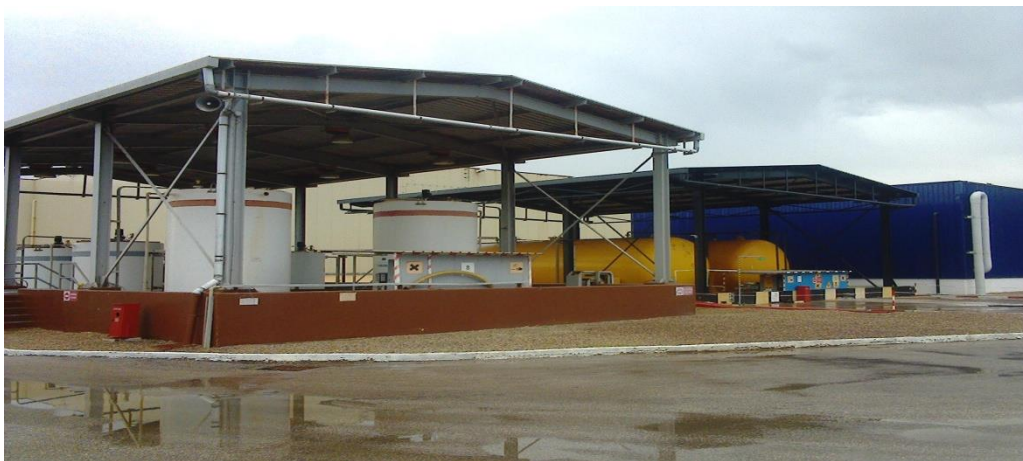
Figure IV. 4: Réservoirs des différents dosages chimiques [57].
