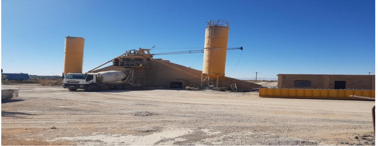
Figure IX.1 : Centrale a béton
