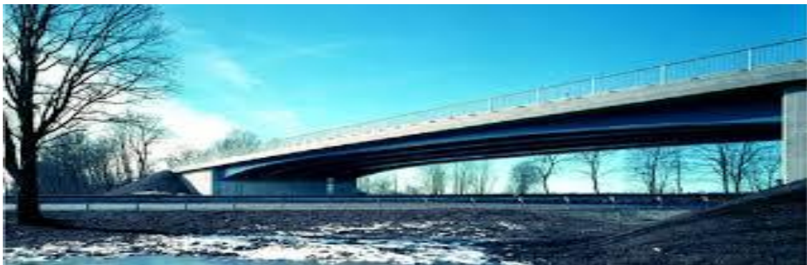
Figure I-9 : BAB A8 structure du pont 5 (SSF), fondation avec rigidité à la flexion élevée
