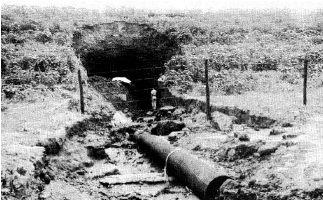
Figure 87: phénomène d'érosion à cause de mauvais contact béton-sol
