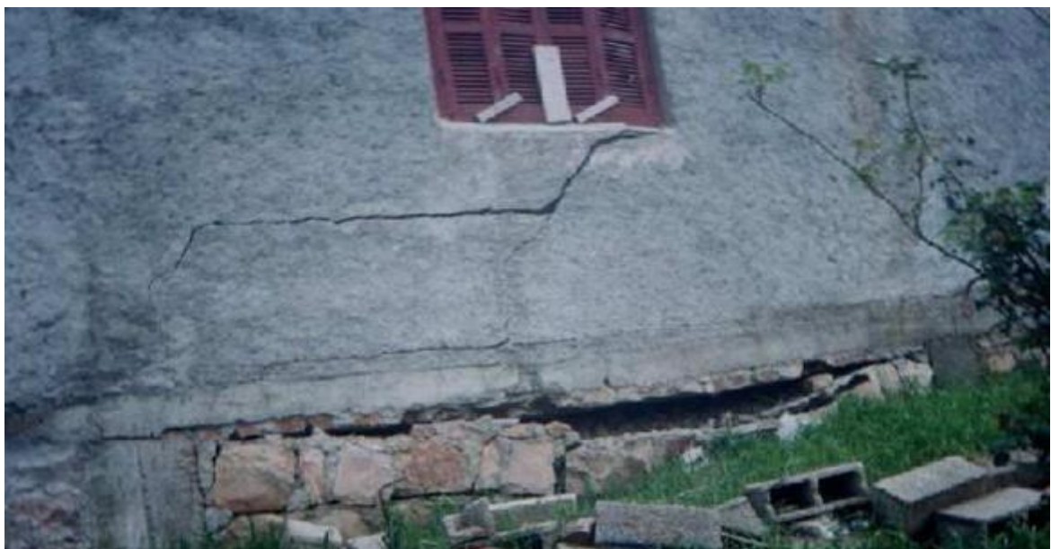
Figure 1 : Désordres au niveau de la longrine d'une maison du village (Belabbaci, 2014).
