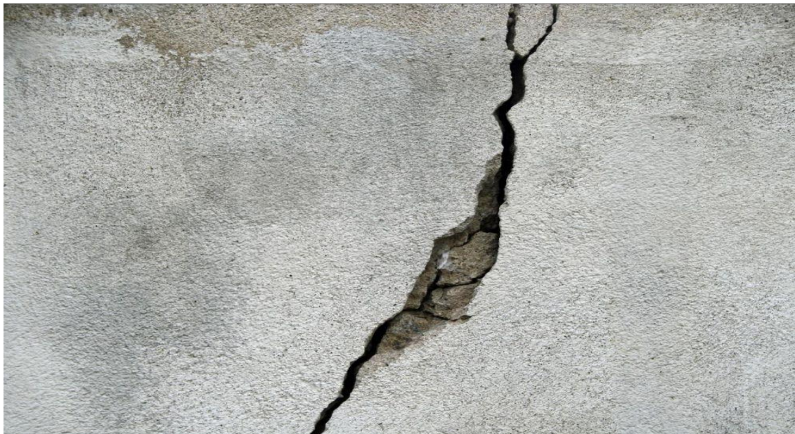
Figure II-2 : Lézarde causée par les sols gonflants (Sermondadaz, 2018).
