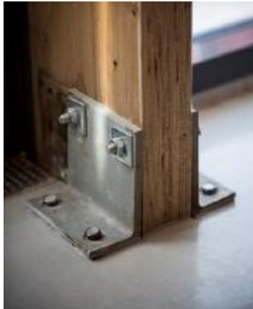
Figure 149 : poteau en bois du marché
