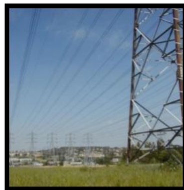
Figure 113: nombreuses lignes électriques
