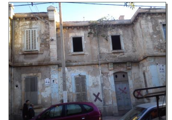
Figure 30 : Construction en mauvaise état
