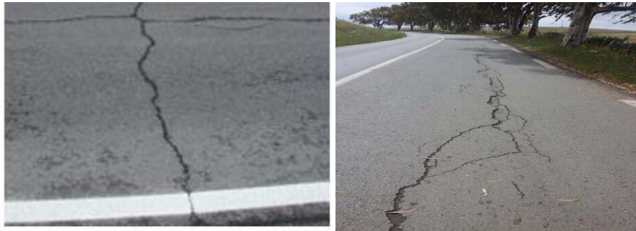
PHOTO 1.1 : FISSURES LONGITUDINALE ET TRANSVERSALE (RN02, 2018)
