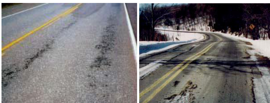
PHOTO 1.4 : GONFLEMENT ET SOULÈVEMENT
