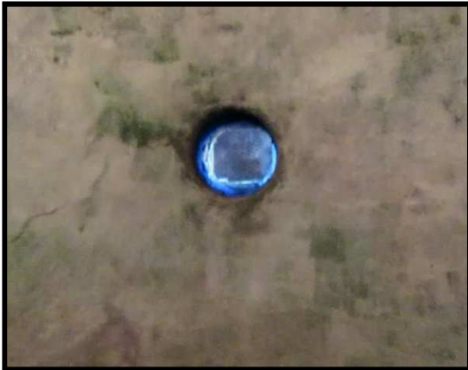
الصورة 36: فتحة تتخلل سقف القاعة الدافئة
