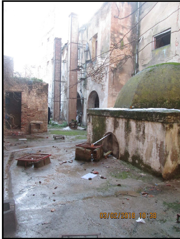
الصورة 73: سطح الحمام
