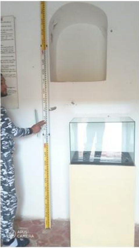
الصورة رقم: (64) كوة غير نافذة في أحد القاعات الداخلية الشمالية لحصن الترك
